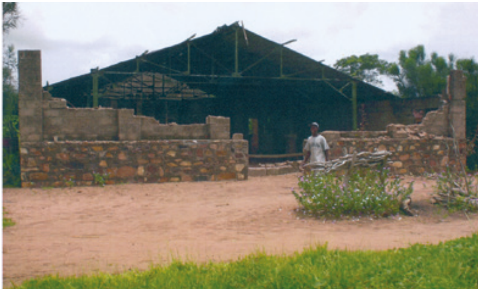
Zustand der Kirche nach dem Sturm
